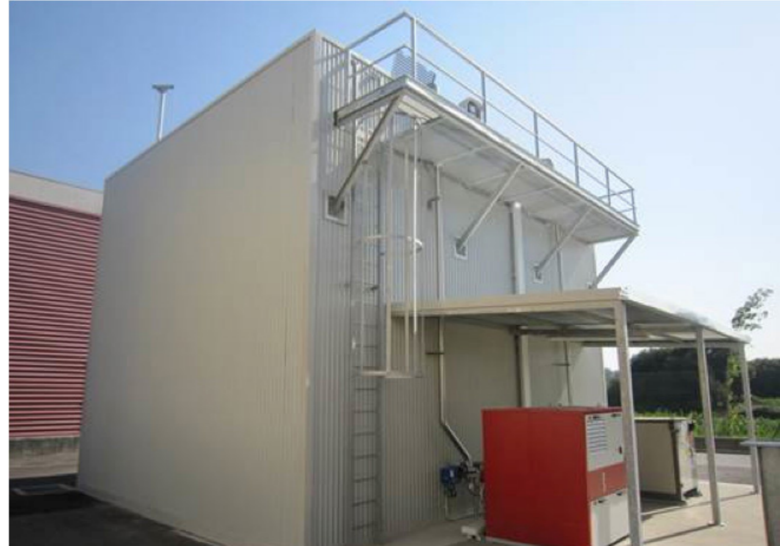
Aspecto exterior del edificio que alberga el tanque de homogeneización enterrado y los dos reactores ELAN® de los que consta el proyecto.
